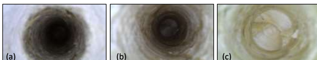
Figura 8 – “Foro 1” perpendicolare alla parete. (a) Ingresso foro, cartongesso. (b) Centro foro, isolante. (c) Fondo foro, elemento ligneo della parete portante.
