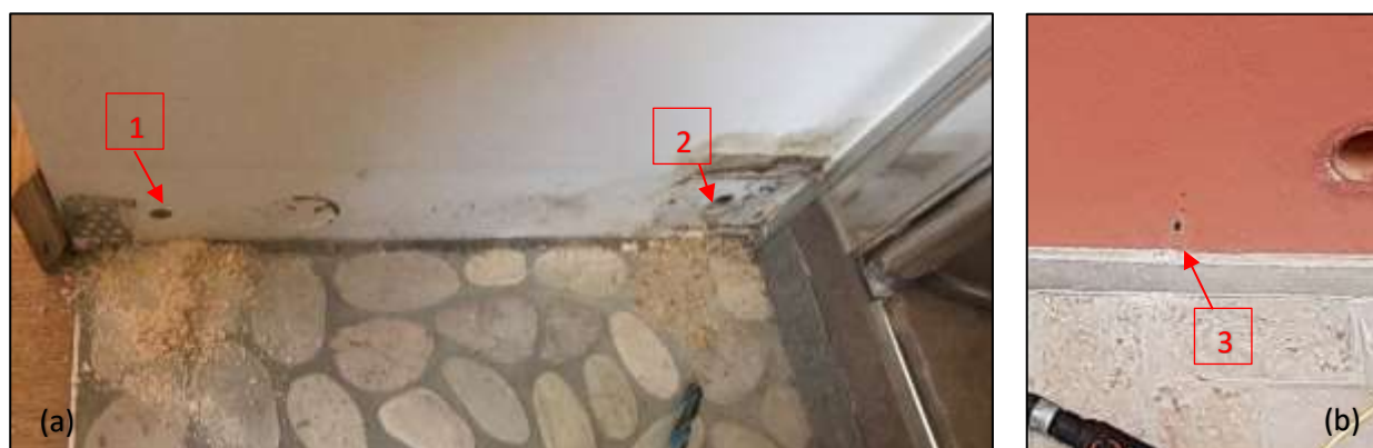
Figura 7 – (a) Fori nella parete interna del bagno e (b) fori nella parete esterna.
